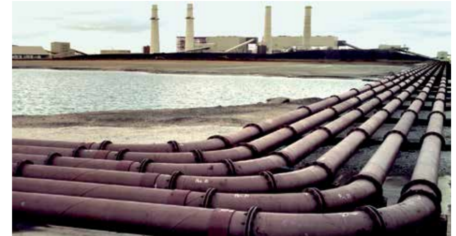
Nassasche-Leitung in Nordamerika; die Rohre haben Flanschverbindungen
