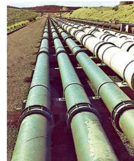
Verschleißgeschützte hydraulische und pneumatische Rohrleitungen
