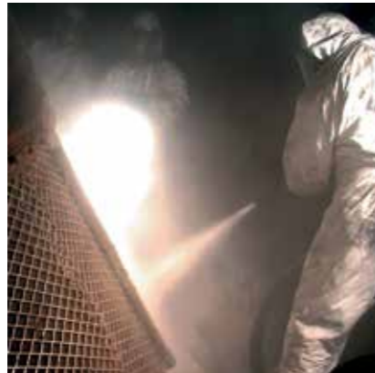
Bei besonders hoher Staubbelastung werden die Abgaskanäle mit Hartstoffkomponent KALCRET oder Hartauftragschweißung KALMETALL geschützt
