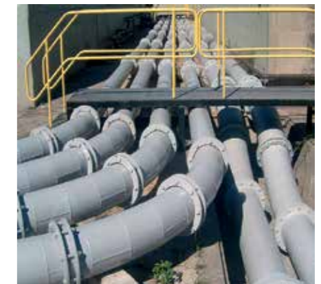
Rohrleitung für mehrere Kraftwerksblöcke zur zentralen Deponie in Brasilien
