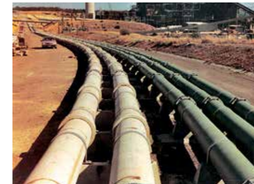
Rohrleitungen in Australien; die Rohre werden mit Victaulic-Kupplungen verbunden
