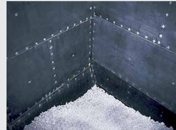
Rohmehlbunker mit gleitfördernder Auskleidung aus KALEN 1006
