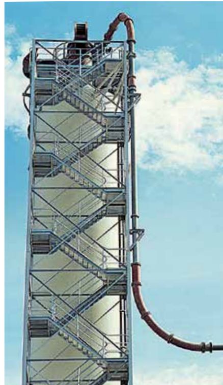
Die Zuführleitungen zu den Zementsilos sind in den Rohrbögen und geraden Nachlaufstücken mit ABRESIST ausgekleidet
