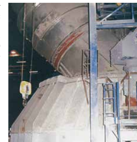
Schutz einer Rohmehlmühle: KALCRET im Rohrsystem, KALMETALL W100 als Mühlenauskleidung
