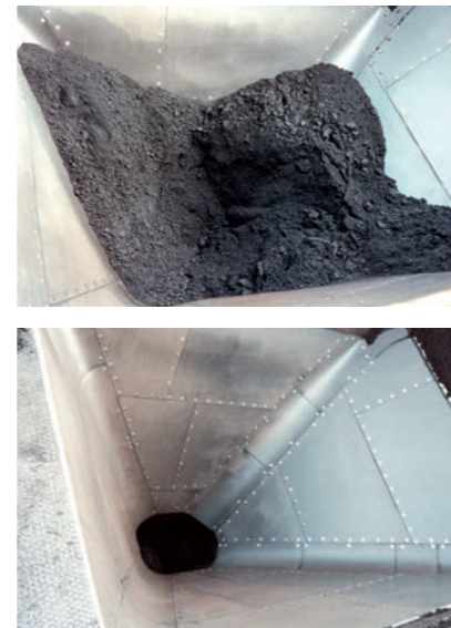
Tiefbunker für Feinkohle: Durch die gleitfördernde Auskleidung fließt das Material ohne Anbackungen und Verstopfungen gleichmäßig ab.
