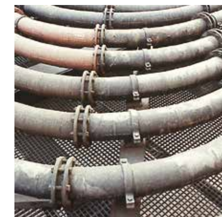
Lange Einsatzzeiten für verschleißgeschützte Rohrleitungen
