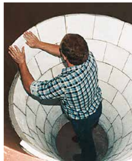
Passgenau gegossene Zirkonkorund KALCOR Formstücke gewährleisten im Konus eines Staubabscheiders sichereren Verschleißschutz auch bei hohen Temperaturen und starken Temperaturwechseln
